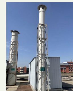
〈廃ガス処理設備(開封太陽金明食品有限公司)〉
